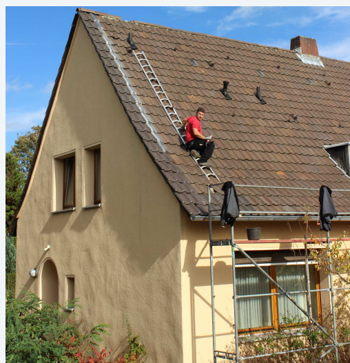
Die Schäden vom Sturmtief Ela konnten endlich ausgebessert werden
